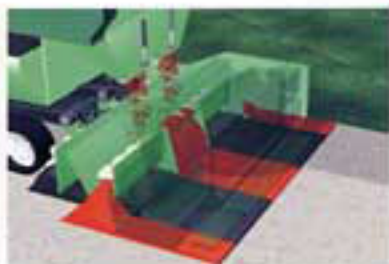
上層用ホッパからその他の部分に普通アスファルト混合物が供給され、同時に帯状に敷きならされます。
